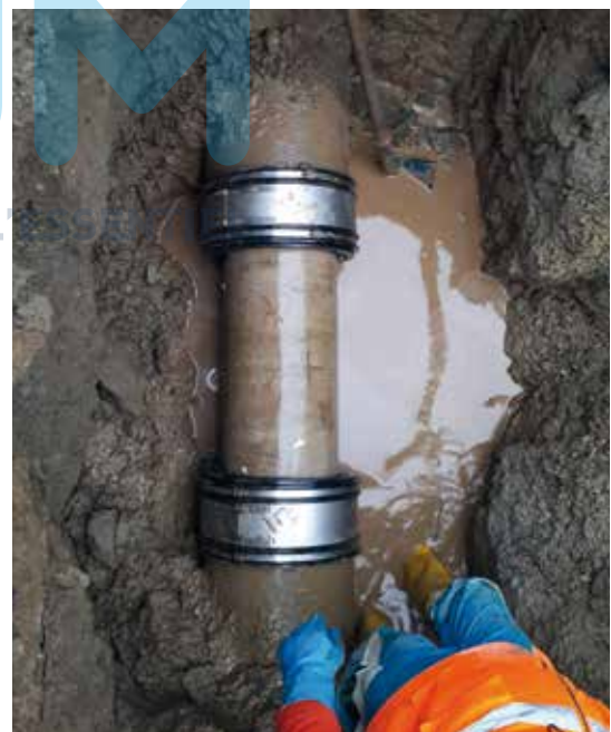
Béton DN 300 (Ø ext. 396) à PRV DN 300 (Ø ext. 324). Raccordement : SC410 + BC32-324-100.
